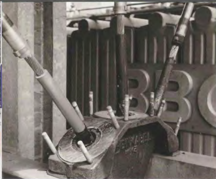
Detailansicht des 30 kV-Transformators
