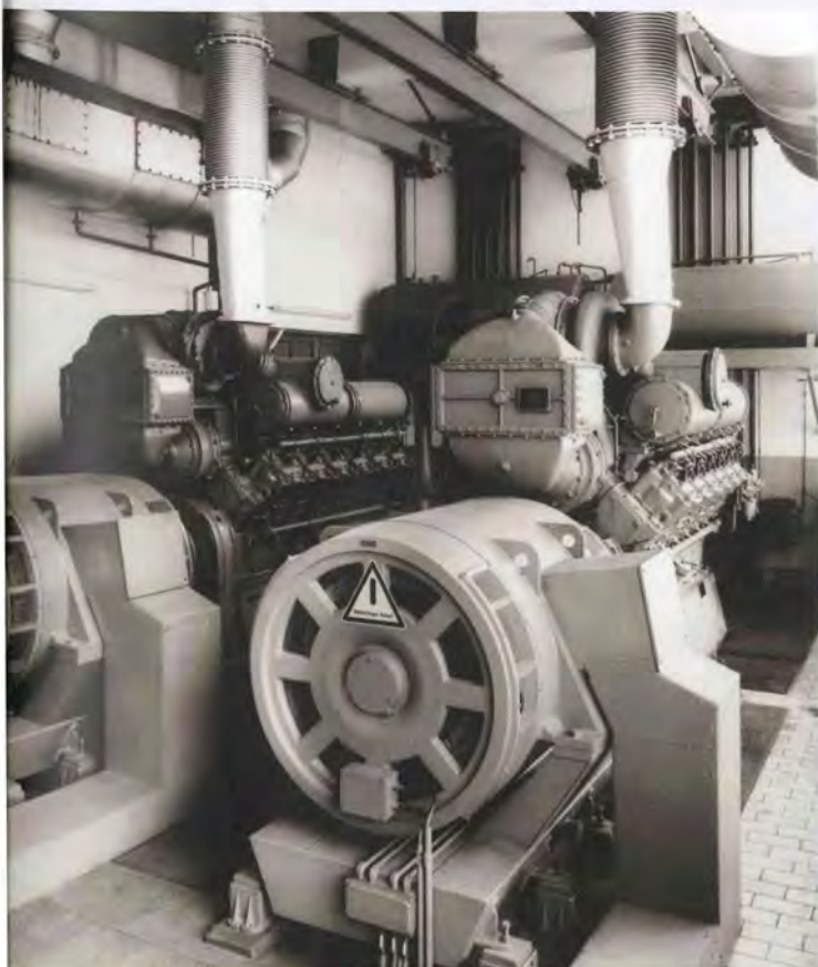
Notstromdieselaggregate im Maschinenhaus
