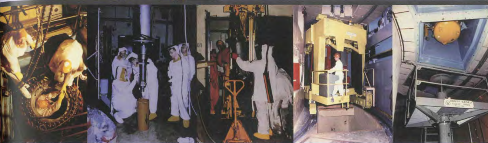
v.l.n.r.: Reinigung eines Ölbehälters der Kühlgasgebläse, Arbeiten an den Brennelementkannen, Rundlaufgerät, Deckelheber unter geöffneter Deckenkammer
