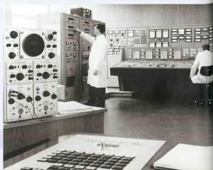
Anlagenüberwachung in der Warte
