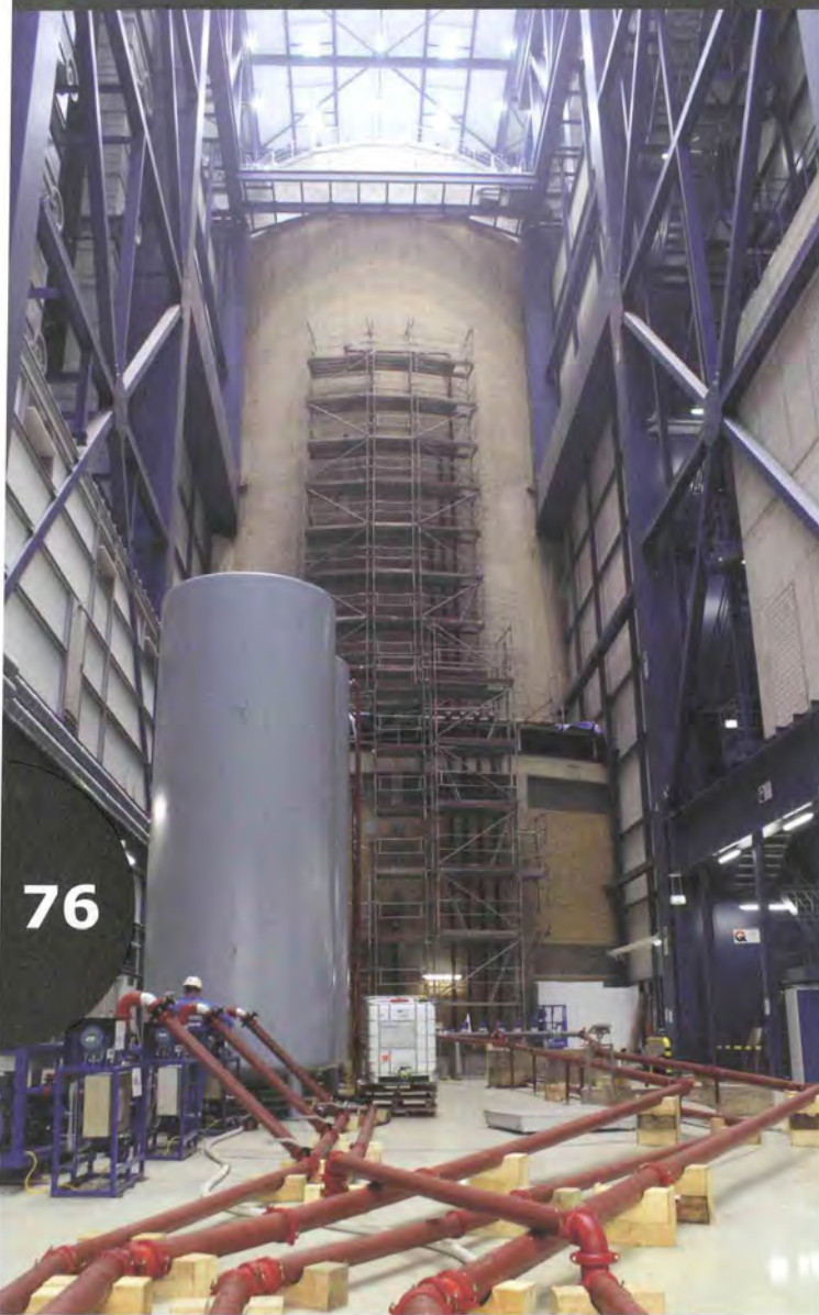
Verfüllrohre in der Materialschleuse
